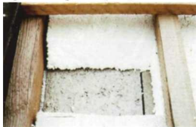
Obr.č. 12: Spárová netěsnost v pěnovém plastu (EPS)
