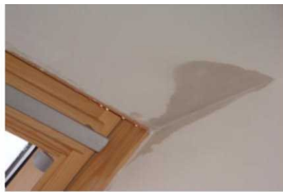
Obr.č.20: Kondenzace na SDK chybnou parozábranou
