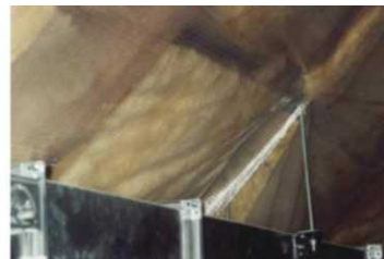
Obr.č.8: Poškození parozábrany táhlem vzduchotechniky
