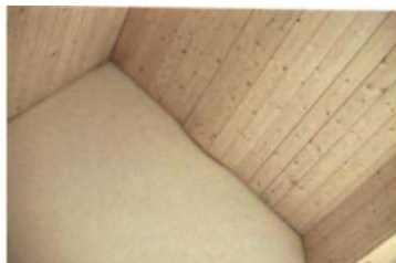
Obr.č.7: Deformace bednění vlivem neslepeného spoje v parozábraně
