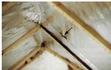
Obr.č.6: Neslepený spoj v parozábraně
