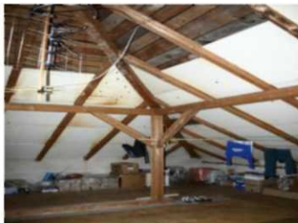
Obr.č. 13: Spárová netěsnost
