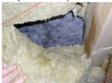
Obr.č.19: Kondenzace pod pojistnou hydroizolací dvouplášťové střechy
