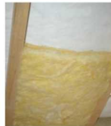
Obr.č. 14: Deformace měkké skelné izolace
